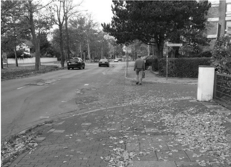
Abb. 3 Fehlende bzw. stark abgefahrene Furtmarkierung in Bremen
